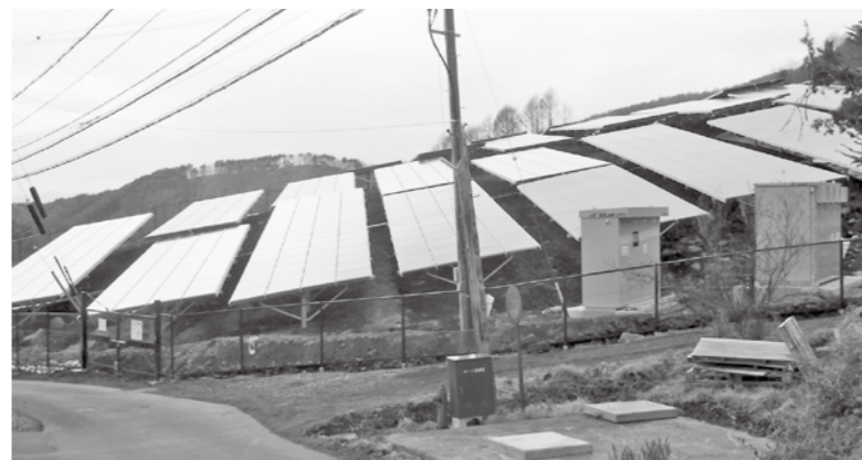
事業者の不適正な工事・設計で工事が中断している奈良原太陽光発電施設
