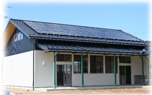
▲新滋野児童館に設置した太陽光パネル
