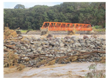
崩落した布下橋の様子
