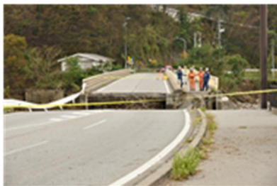
崩落した田中橋の様子
