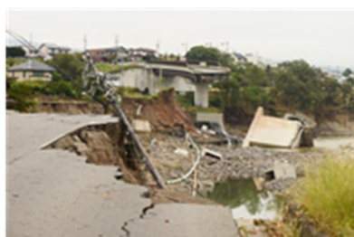
崩落した海野宿橋の様子
