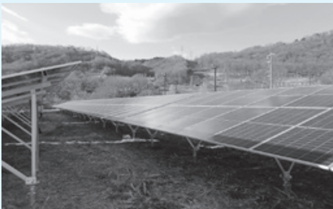
北御牧地区に設置された太陽光発電施設
