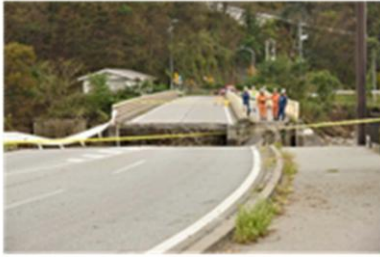
崩落した田中橋の様子
