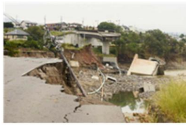
崩落した海野宿橋の様子
