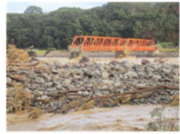
崩落した布下橋の様子
