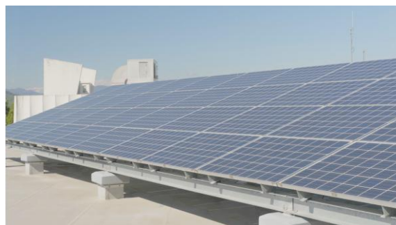
◆市役所屋上の太陽光パネル
