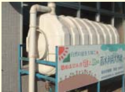
市役所の前にある雨水貯留槽
