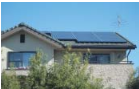
▲太陽光パネル
