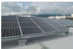
▲太陽光発電システム
