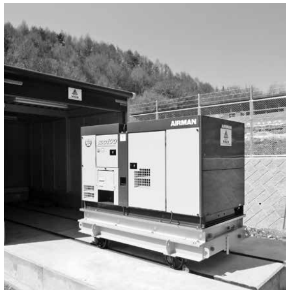
西入水源浄水施設に設置された非常用発電機
