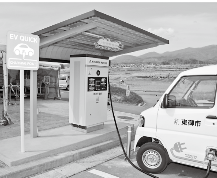
道の駅に設置された電気自動車充電設備
