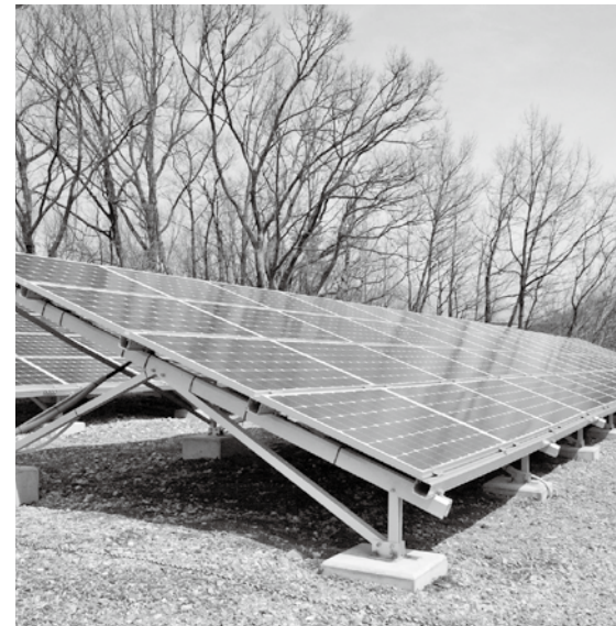
小規模な太陽光発電施設
