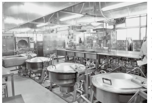
給食センター内部
