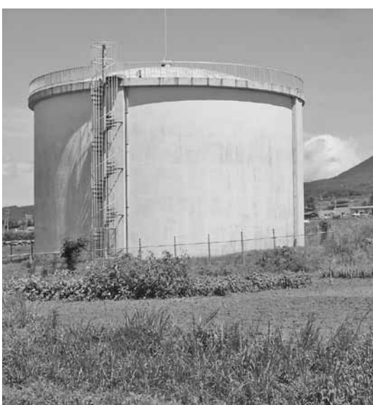
上水道貯水タンク
