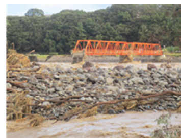
崩落した布下橋の様子
