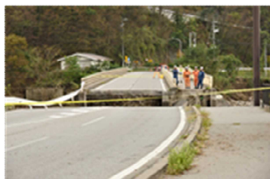
崩落した田中橋の様子
