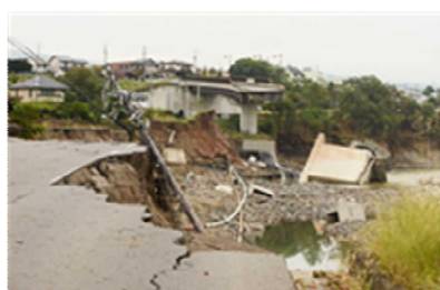
崩落した海野宿橋の様子
