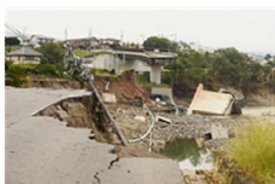
崩落した海野宿橋の様子
