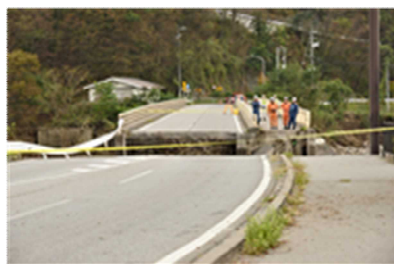
崩落した田中橋の様子
