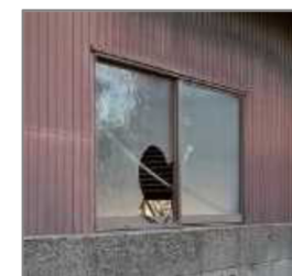
窓が割れた管理不全空家
