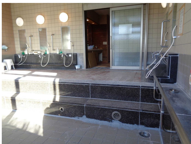
▲高齢者センター浴室
