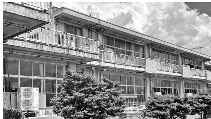
塗装が傷んだ校舎
