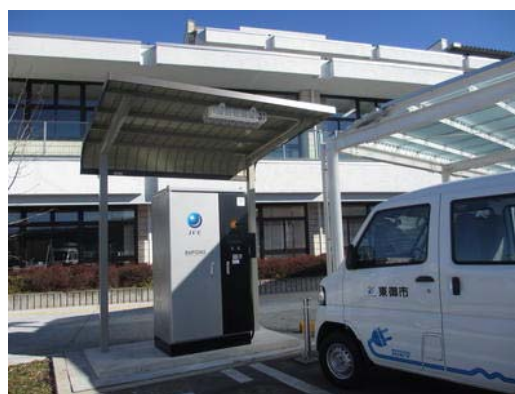
❖ 急速充電設備と電気自動車（右）
