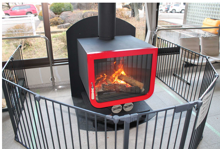
✳️ 北御牧庁舎に 導入した薪ストーブ
