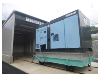
図 水道施設用の緊急用発電設備（西入浄水施設）
