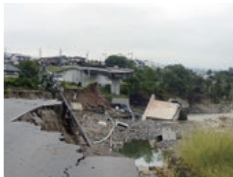
⑪台風第19号被災後の海野宿橋
