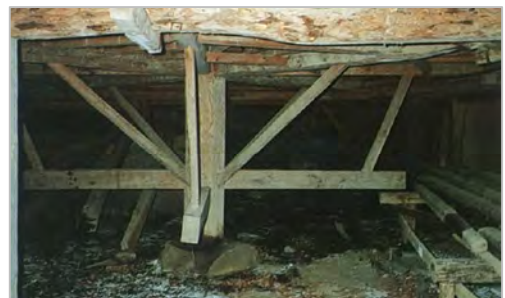
写真：回り舞台の床下の構造（奈落）
