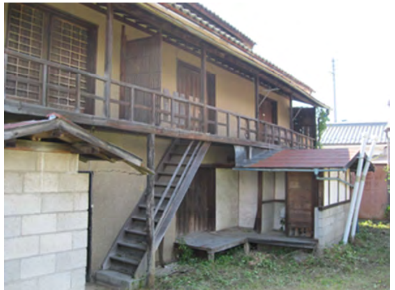
写真：空き家となり老朽化の進んだ建物（蚕室裏側）
