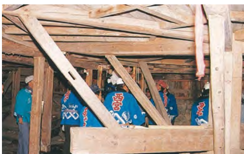
写真：回り舞台の床下の構造（奈落）
