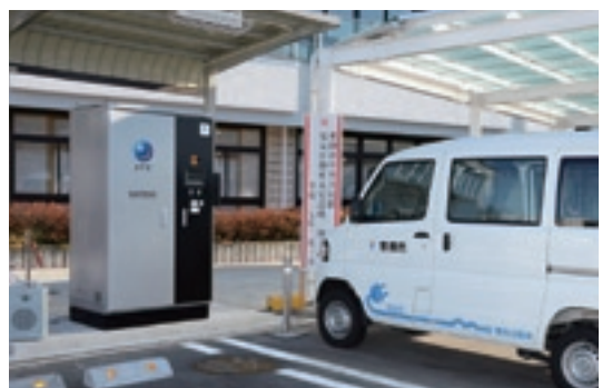
▲急速充電設備（蓄電池内蔵で、停電時の非常用電源としても活用可能）
