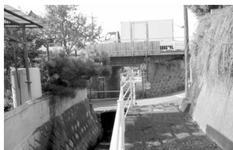
改修が予定されている金原川(国道18号線と金原川が交差する白鳥台)
