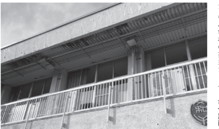
劣化した小学校校舎の庇
