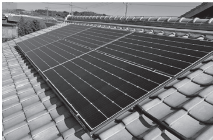
太陽光発電設備
