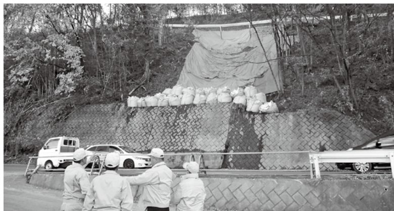
台風21号で土砂崩落した県道羽毛山大日向線
